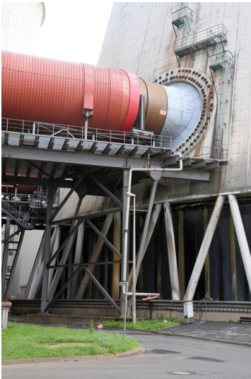
Kraftwerk Neurath: Reingaseinleitung Kühlturm E, Ansicht von Westen; Foto: 12.09.2023 Fotograf/Urheber: Dr. Norbert Gilson
