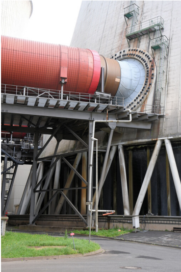
Kraftwerk Neurath: Reingaseinleitung Kühlturm E, Ansicht von Westen; Foto: 12.09.2023 Fotograf/Urheber: Dr. Norbert Gilson
