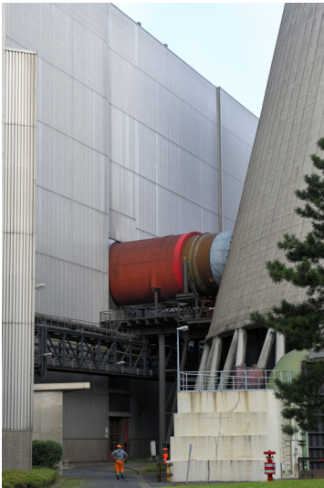
Kraftwerk Neurath: Reingaseinleitung Kühlturm D, Ansicht von Süden; Foto: 12.09.2023 Fotograf/Urheber: Dr. Norbert Gilson
