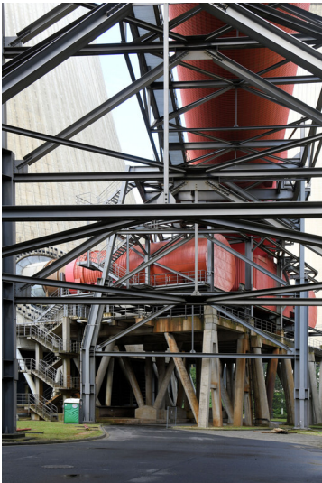
Kraftwerk Neurath: Reingaseinleitung Kühlturm C, Führung des Reingaskanals zum Kühlturm, Ansicht von Osten; Foto: 12.09.2023 Fotograf/Urheber: Dr. Norbert Gilson
