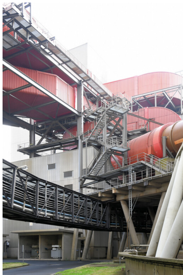
Kraftwerk Neurath: Reingaseinleitung Kühlturm A, Reingasrohr vor Einleitung in den Kühlturm (rechts im Bild), Ansicht von Westen; Foto: 12.09.2023 Fotograf/Urheber: Dr. Norbert Gilson
