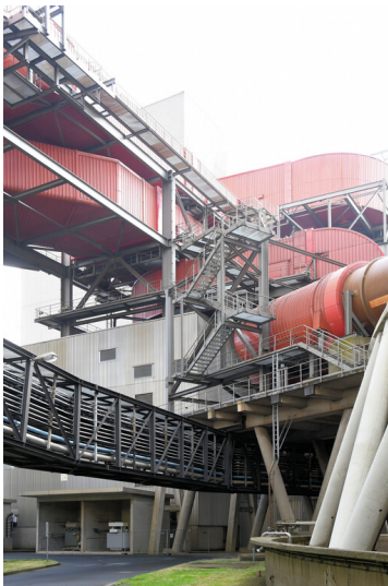
Kraftwerk Neurath: Reingaseinleitung Kühlturm A, Reingasrohr vor Einleitung in den Kühlturm (rechts im Bild), Ansicht von Westen; Foto: 12.09.2023 Fotograf/Urheber: Dr. Norbert Gilson
