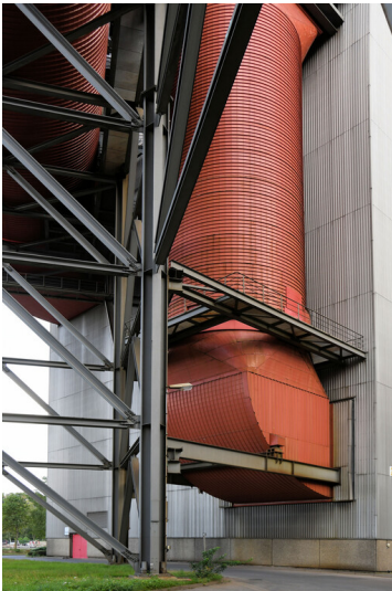
Kraftwerk Neurath: Absorbergebäude E, Einführung von Rohgaskanälen, Ansicht von Südwesten; Foto: 12.09.2023 Fotograf/Urheber: Dr. Norbert Gilson
