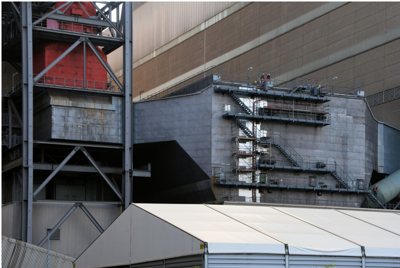
Kraftwerk Neurath: Elektrofilter Block E, Ansicht von Nordwesten; Foto: 12.09.2023 Fotograf/Urheber: Dr. Norbert Gilson
