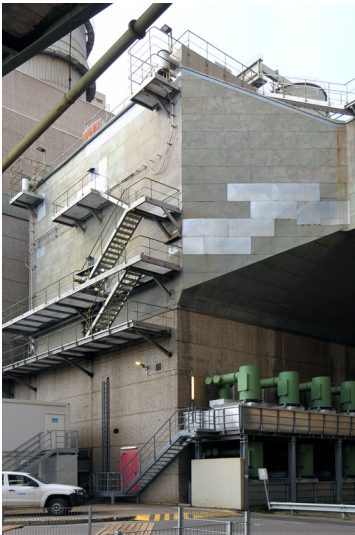
Kraftwerk Neurath: Elektrofilter Block A, Ansicht von Nordosten; Foto: 12.09.2023 Fotograf/Urheber: Dr. Norbert Gilson
