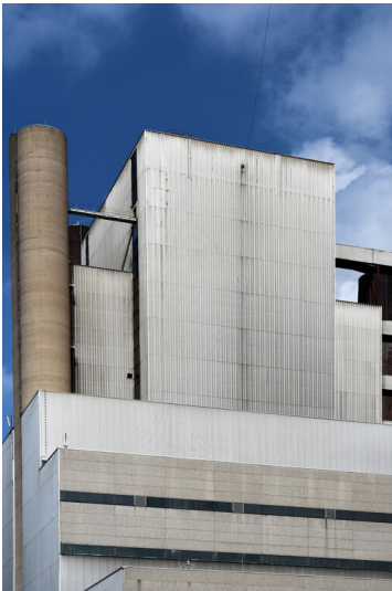
Kraftwerk Neurath: Kesselhaus Block E, Ansicht von Süden; Foto: 12.09.2023 Fotograf/Urheber: Dr. Norbert Gilson
