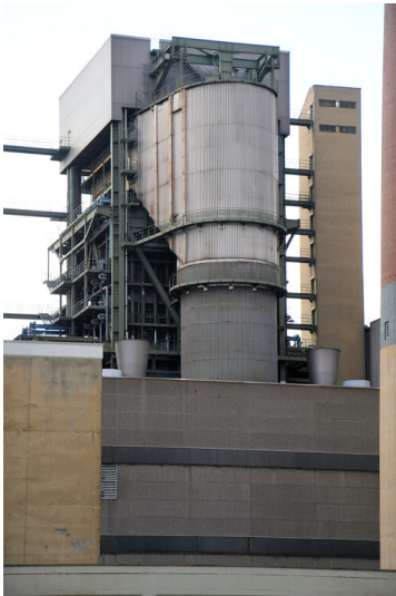
Kraftwerk Neurath: Kesselhaus und Kessel (mit Rauchgasleerzug) von Block C, Ansicht von Nordosten; Foto: 12.09.2023 Fotograf/Urheber: Dr. Norbert Gilson
