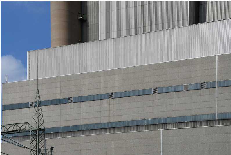
Kraftwerk Neurath: Zwischenbau Block E, Ansicht von Süden; Foto: 12.09.2023 Fotograf/Urheber: Dr. Norbert Gilson
