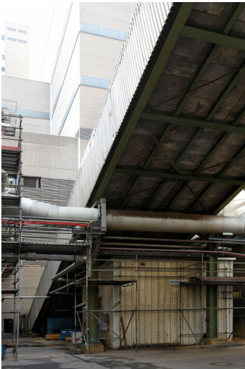
Kraftwerk Neurath: Bekohlungsweg Brecherei - Blöcke D/E, Ausgang der Schrägbandbrücke aus dem Brechereigebäude, Ansicht von Westen; Foto: 12.09.2023 Fotograf/Urheber: Dr. Norbert Gilson
