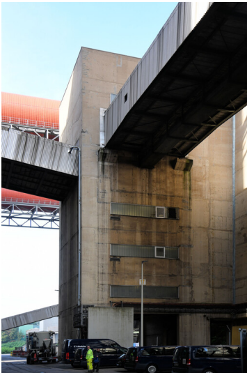
Kraftwerk Neurath: Bekohlungssekturm D/E, Ansicht von Südosten; Foto: 12.09.2023 Fotograf/Urheber: Dr. Norbert Gilson
