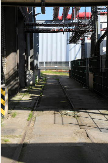
Kraftwerk Goldenberg-Werk: Trafogleis vor dem Schaltanlagenvorbau (links), Ansicht von Südosten; Foto: 25.05.2023 Fotograf/Urheber: Dr. Norbert Gilson
