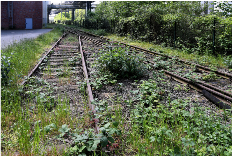
Kraftwerk Goldenberg-Werk: Abzweig der Gleiszufahrt zur Öl-/Kalkübernahme (links) von dem im Südwesten verlaufenden Kraftwerksgleis, Ansicht von Nordwesten; Foto: 25.05.2023 Fotograf/Urheber: Dr. Norbert Gilson
