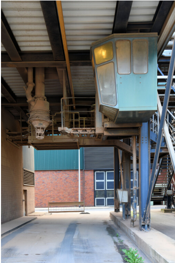
Kraftwerk Goldenberg-Werk: Aschekalkverdichterstation, Ascheverladung, Ansicht von Südwesten; Foto: 25.05.2023 Fotograf/Urheber: Dr. Norbert Gilson
