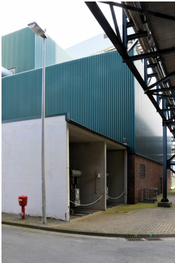
Kraftwerk Goldenberg-Werk: Schaltanlagegebäude für die Hilfsdampferzeuger L/M mit Trafoszellen, Ansicht von Süden; Foto: 25.05.2023 Fotograf/Urheber: Dr. Norbert Gilson
