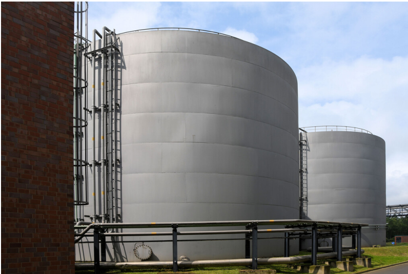
Kraftwerk Goldenberg-Werk: Leichtöltank 1 (im Hintergrund Leichtöltank 2), Ansicht von Südosten; Foto: 23.05.2023 Fotograf/Urheber: Dr. Norbert Gilson
