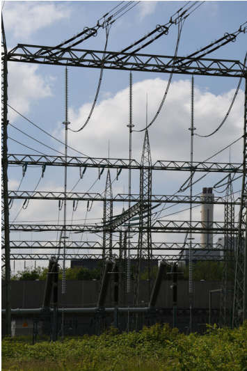
Kraftwerk Goldenberg-Werk: Freileitungsabgangsfeld zur Mastenreihe mit der BI-Nr. 2301, Ansicht von Nordosten; Foto: 25.05.2023 Fotograf/Urheber: Dr. Norbert Gilson
