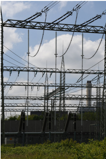
Kraftwerk Goldenberg-Werk: Freileitungsabgangsfeld zur Mastenreihe mit der BI-Nr. 2301, Ansicht von Nordosten; Foto: 25.05.2023 Fotograf/Urheber: Dr. Norbert Gilson
