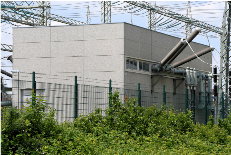
Kraftwerk Goldenberg-Werk: 380-kV-Innenraumschaltanlage, Schaltheis, Ansicht von Osten; Foto: 25.05.2023 Fotograf/Urheber: Dr. Norbert Gilson
