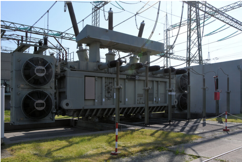
Kraftwerk Goldenberg-Werk: 110-kV-Umspannanlage Knapsack, Trafo 411, Ansicht von Westen; Foto: 25.05.2023 Fotograf/Urheber: Dr. Norbert Gilson
