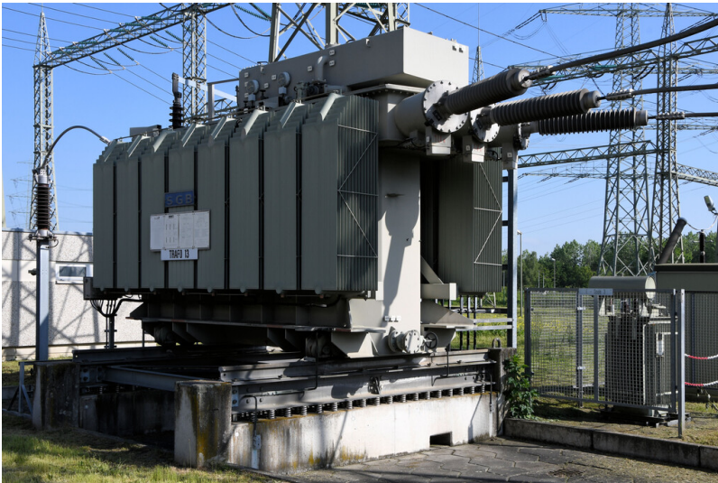
Kraftwerk Goldenberg-Werk: 110-kV-Umspannanlage Knapsack, Trafo 13, Ansicht von Süden; Foto: 25.05.2023 Fotograf/Urheber: Dr. Norbert Gilson
