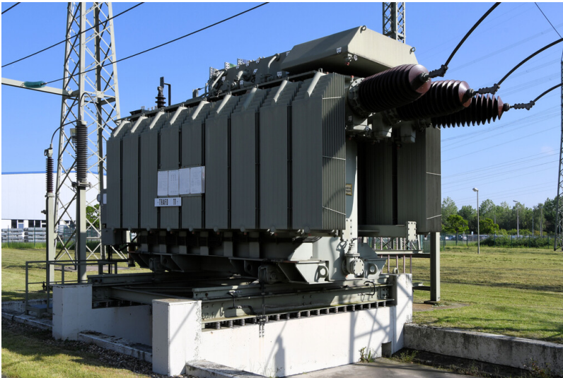
Kraftwerk Goldenberg-Werk: 110-kV-Umspannanlage Knapsack, Trafo 11, Ansicht von Süden; Foto: 25.05.2023 Fotograf/Urheber: Dr. Norbert Gilson
