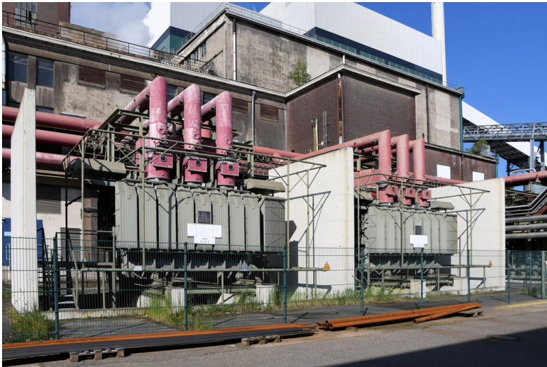
Kraftwerk Goldenberg-Werk: Eigenbedarfstransformator E3 (links) und F3 (rechts), Ansicht von Osten; Foto: 25.05.2023 Fotograf/Urheber: Dr. Norbert Gilson
