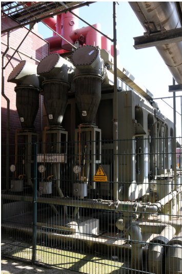
Kraftwerk Goldenberg-Werk: Blocktrafo F 11 für Maschine F, Ansicht von Südwesten; Foto: 25.05.2023 Fotograf/Urheber: Dr. Norbert Gilson
