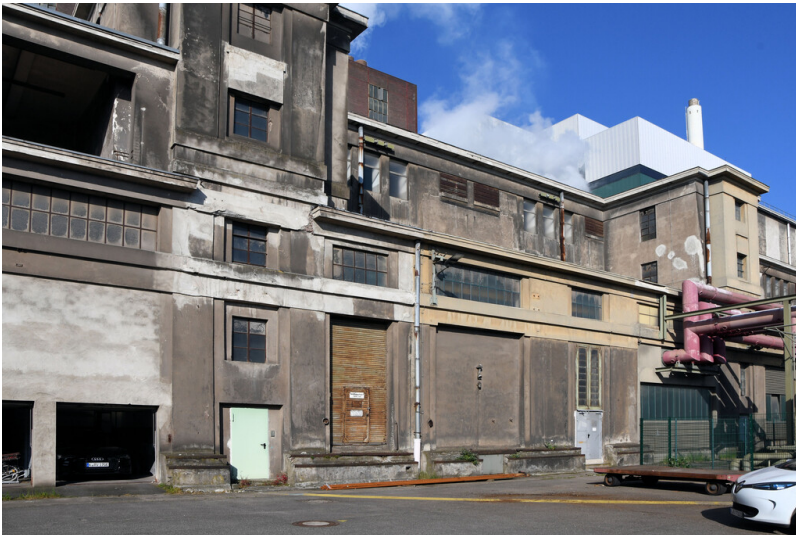
Kraftwerk Goldenberg-Werk: Schaltanlagenvorbau (25-kV-Schaltanlage), mittlerer Gebäudeteil, Ansicht von Osten; Foto: 25.05.2023 Fotograf/Urheber: Dr. Norbert Gilson
