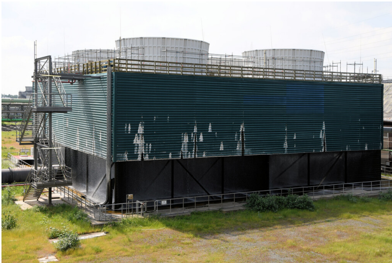
Kraftwerk Goldenberg-Werk: Kühler 1, Ansicht von Norden; Foto: 25.05.2023 Fotograf/Urheber: Dr. Norbert Gilson
