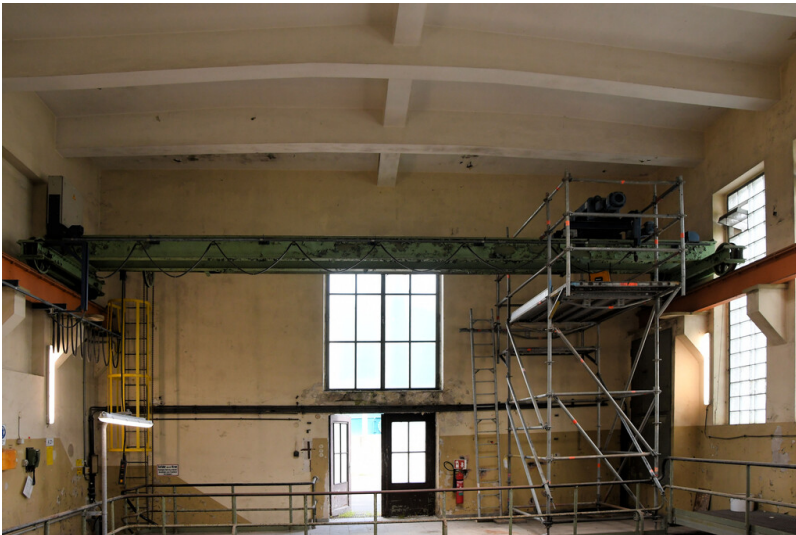
Kraftwerk Goldenberg-Werk: Betriebswasser-Pumpenhaus, Innenansicht von Südosten; Foto: 25.05.2023 Fotograf/Urheber: Dr. Norbert Gilson
