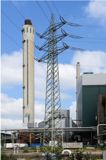
Kraftwerk Goldenberg-Werk: 110-kV-Hochspannungsfreileitung Go-Werk - Kierdorf (Bauleitnummer 0084), Mast 1C, Ansicht von Südosten; Foto: 25.05.2023 Fotograf/Urheber: Dr. Norbert Gilson
