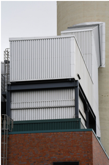
Kraftwerk Goldenberg-Werk: Reingaseinleitung aus Saugzug DE-K in den Kamin J/K, Ansicht von Nordwesten; Foto: 23.05.2023 Fotograf/Urheber: Dr. Norbert Gilson
