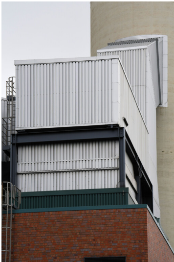
Kraftwerk Goldenberg-Werk: Reingaseinleitung aus Saugzug DE-K in den Kamin J/K, Ansicht von Nordwesten; Foto: 23.05.2023 Fotograf/Urheber: Dr. Norbert Gilson
