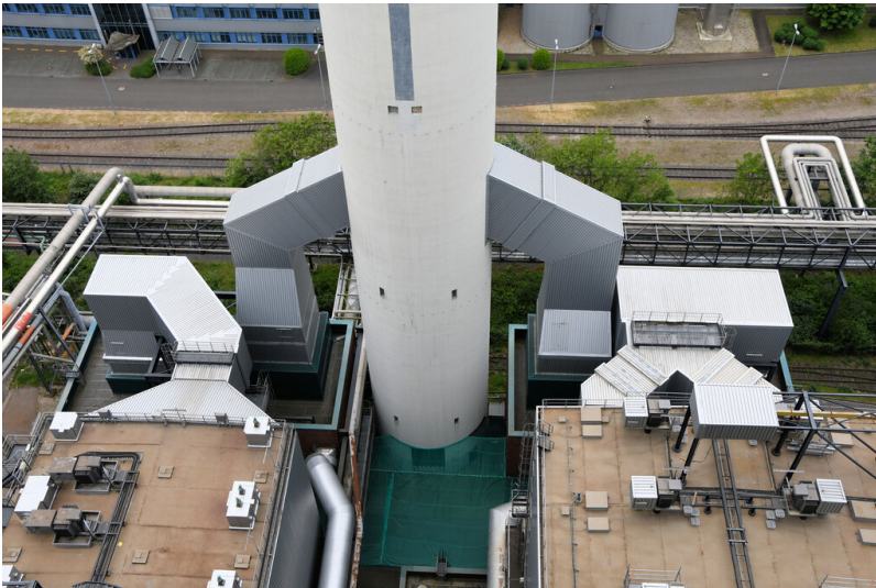
Kraftwerk Goldenberg-Werk: Elektrofilter J (links unten), Saugzuggebäude und Saugzugkanäle DE-J (links Mitte), Ansicht von Nordosten (vom Dach des Kesselhauses DE K); Foto: 23.05.2023 Fotograf/Urheber: Dr. Norbert Gilson
