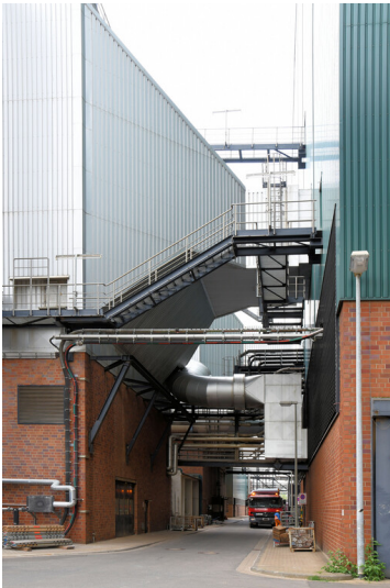
Kraftwerk Goldenberg-Werk: E-Filter J, Rauchgasausleitung aus Kesselhaus DE J und Einleitung in den E-Filter, Ansicht von Südosten; Foto: 23.05.2023 Fotograf/Urheber: Dr. Norbert Gilson
