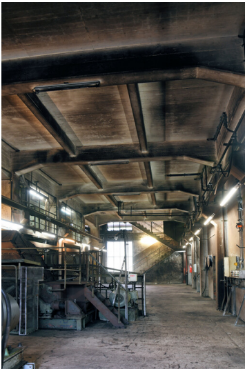
Kraftwerk Goldenberg-Werk: Nachbrechergebäude, Raum für die Aufstellung der Brecher; Foto: 23.05.2023 Fotograf/Urheber: Dr. Norbert Gilson
