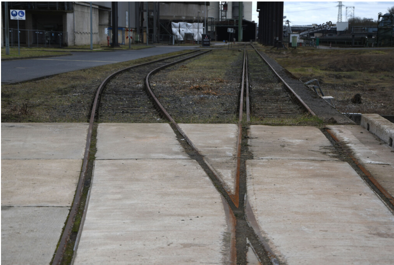
Kraftwerk Frimmersdorf II: Werkgleis, Stichgleise vom Aschegleis zum Kalkbahnhof, Ansicht von Nordosten; Foto: 22.03.2023 Fotograf/Urheber: Dr. Norbert Gilson
