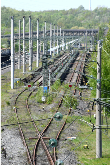
Kraftwerk Frimmersdorf II: Bahnhof Frimmersdorf, Zufahrtsgleise und auf den Betonkragarmen verlaufende Bunkergleise, Ansicht von Osten; Foto: 04.05.2023 Fotograf/Urheber: Dr. Norbert Gilson
