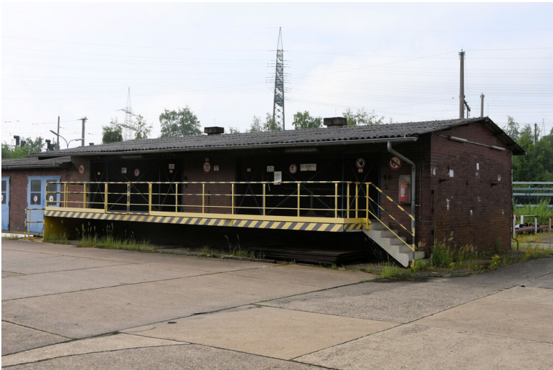
Kraftwerk Frimmersdorf II: Freilager, westlicher Gebädetrakt mit Verladerrampe, Ansicht von Norden; Foto: 23.06.2023 Fotograf/Urheber: Dr. Norbert Gilson
