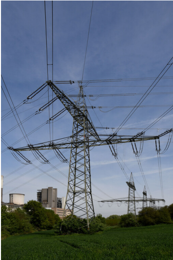
Kraftwerk Frimmersdorf II: Abspannmast 32B (im Vordergrund) sowie 32C, 32D und 32E (im Hintergrund), Ansicht von Süden; Foto: 04.05.2023 Fotograf/Urheber: Dr. Norbert Gilson
