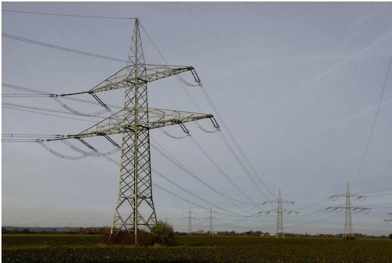
Kraftwerk Frimmersdorf II: Abspannmast 1 der Leitung Bl-Nr. 4535 an der Umspannanlage Rommerskirchen, jetzt Einführung der 380-kV-Leitung von Block F/G Kraftwerk Neurath (linke Traverse) sowie einer weiteren Leitung (rechte Traverse), Ansicht von Norden; Foto: 22.11.2023 Fotograf/Urheber: Dr. Norbert Gilson
