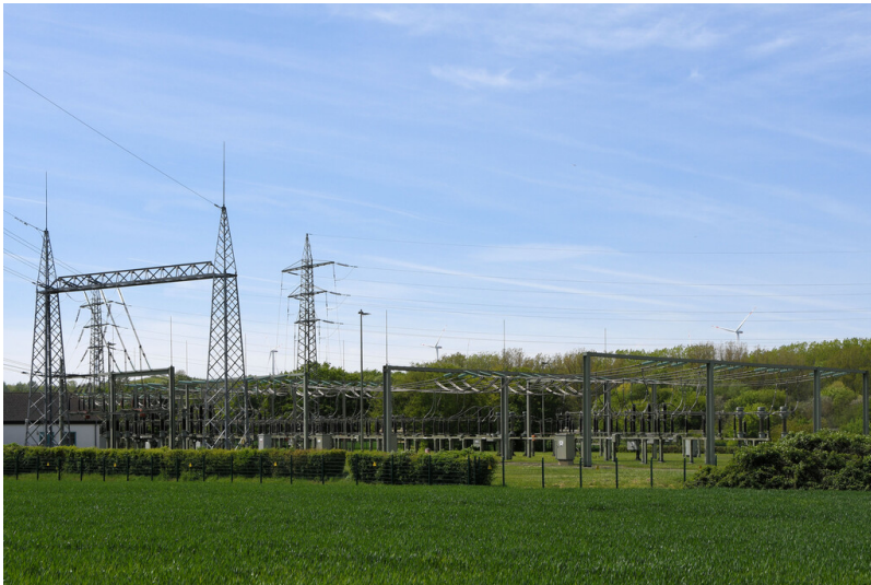
Kraftwerk Frimmersdorf II: Abspannportal zur Einführung (Leitungsseile ganz links) der von der Umspannanlage Welchenberg zur Schaltanlage Frimmersdorf führenden Hochspannungsleitung, Ansicht von Nordosten; Foto: 04.05.2023 Fotograf/Urheber: Dr. Norbert Gilson
