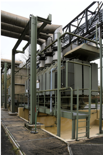
Kraftwerk Frimmersdorf II: Eigenbedarfstransformator Block P, Ansicht von Westen; Foto: 21.03.2023 Fotograf/Urheber: Dr. Norbert Gilson
