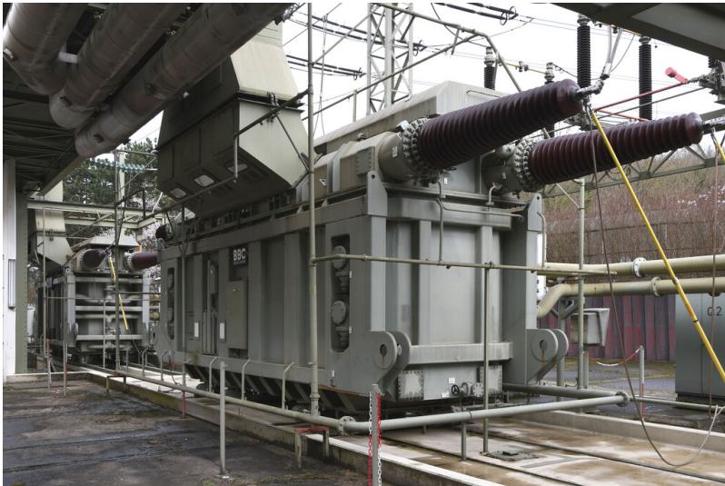
Kraftwerk Frimmersdorf II: Maschinentransformatoren Block Q, Ansicht von Südwesten; Foto: 21.03.2023 Fotograf/Urheber: Dr. Norbert Gilson
