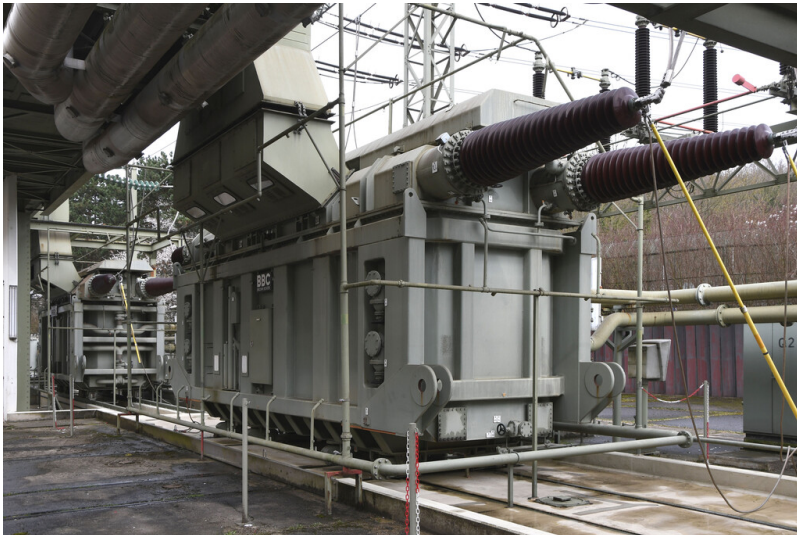
Kraftwerk Frimmersdorf II: Maschinentransformatoren Block Q, Ansicht von Südwesten; Foto: 21.03.2023 Fotograf/Urheber: Dr. Norbert Gilson
