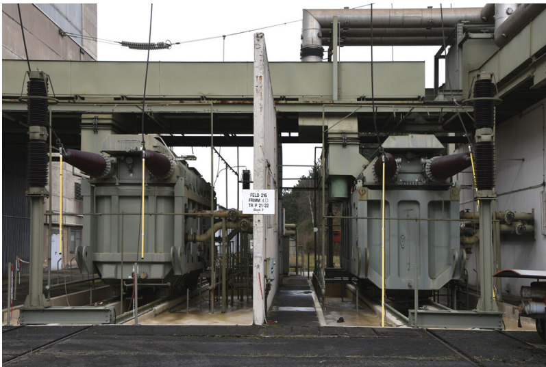
Kraftwerk Frimmersdorf II: Maschinentransformatoren P21/22 Block P, Ansicht von Süden; Foto: 21.03.2023 Fotograf/Urheber: Dr. Norbert Gilson
