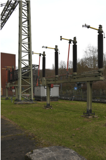
Kraftwerk Frimmersdorf II: Freileitungsabgangsfeld Block O, Trennschalter, Ansicht von Süden; Foto: 21.03.2023 Fotograf/Urheber: Dr. Norbert Gilson
