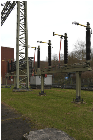
Kraftwerk Frimmersdorf II: Freileitungsabgangsfeld Block O, Trennschalter, Ansicht von Süden; Foto: 21.03.2023 Fotograf/Urheber: Dr. Norbert Gilson
