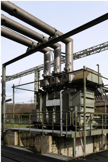
Kraftwerk Frimmersdorf II: Eigenbedarfstransformator der Anfahr-Anlage 2, Ansicht von Südwesten; Foto: 21.03.2023 Fotograf/Urheber: Dr. Norbert Gilson
