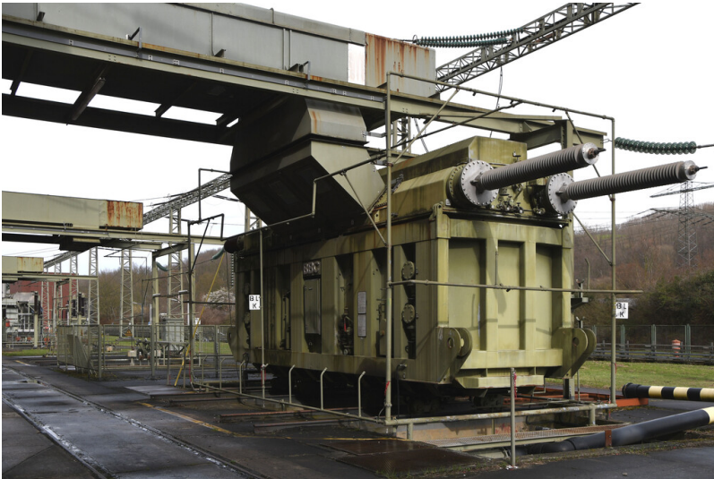
Kraftwerk Frimmersdorf II: Maschinentransformator Blöcke K/L, Ansicht von Südwesten; Foto: 21.03.2023 Fotograf/Urheber: Dr. Norbert Gilson
