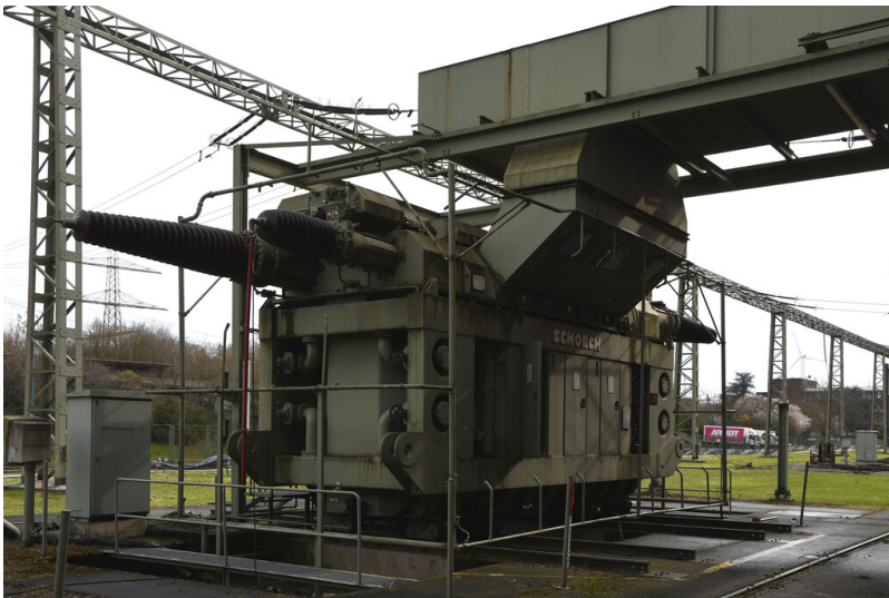
Kraftwerk Frimmersdorf II: Maschinentransformator Block F, Ansicht von Norden; Foto: 21.03.2023 Fotograf/Urheber: Dr. Norbert Gilson
