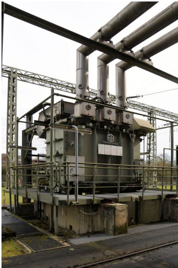
Kraftwerk Frimmersdorf II: Eigenbedarfstransformator der Anfahr-Anlage 1, Ansicht von Norden; Foto: 21.03.2023 Fotograf/Urheber: Dr. Norbert Gilson
