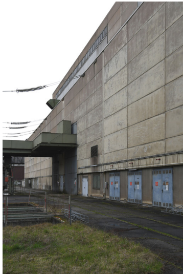
Kraftwerk Frimmersdorf II: Schaltanlagenvorbau Block Q, Ansicht von Nordosten; Foto: 21.03.2023 Fotograf/Urheber: Dr. Norbert Gilson
