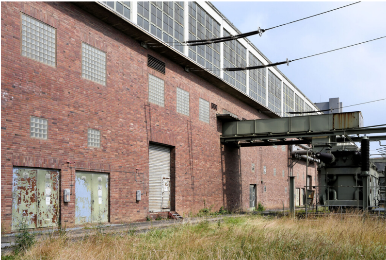
Kraftwerk Frimmersdorf II: Schaltanlagenvorbau Block E, Ansicht von Südosten; Foto: 23.06.2023 Fotograf/Urheber: Dr. Norbert Gilson
